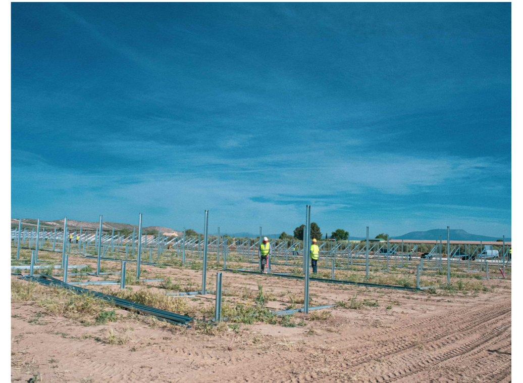
Instalaciones fotovoltaicas diseñadas por Cuerva en Camino de Ácula.
